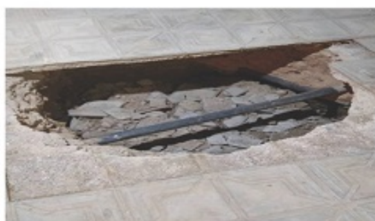
نشست خاک بر اثر شکستگی شاه لوله آب شرب و ایجاد ترک در دیوارهای مجاور
