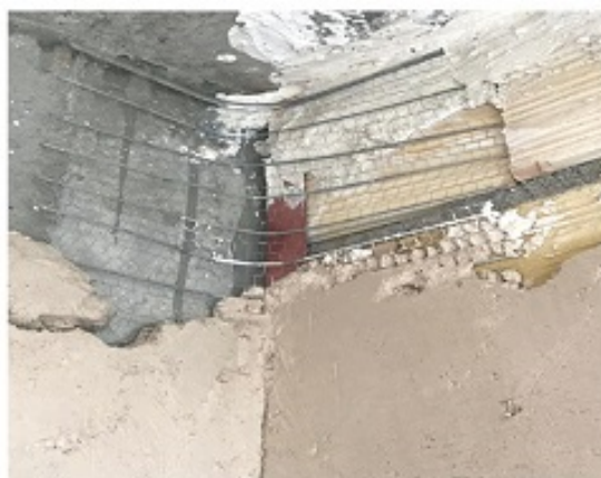
پیشگیری از ترک خوردگی در دیوار برشی و محل وال پست
