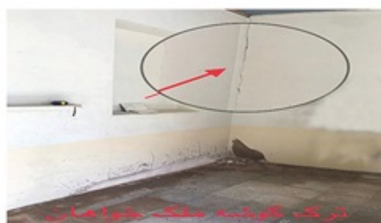
ترک خوردگی ناشی از نشست ملک مجاور
