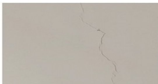
ترک خوردگی ناشی از استفاده از لودر در خاکبرداری
