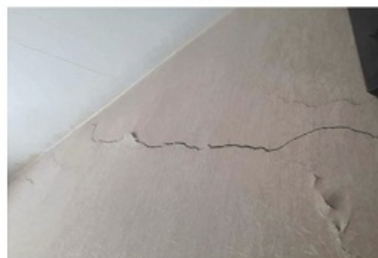
ترک قطری ناشی از نشست
